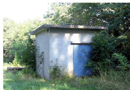
Station de pompage à Veigy
