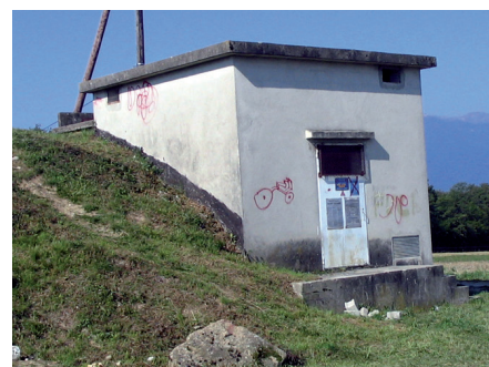
Réservoir des Vignes
