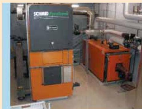
La chaudière bois (à gauche) et la chaudière fioul (à droite).
