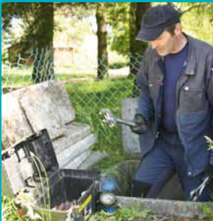
Pose de plus de 2000 compteurs individuels permettant la radio-relève et la surveillance de fuites chez les abonnés.
