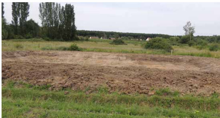
Le bassin tampon pour retarder l'écoulement des eaux pluviales.
