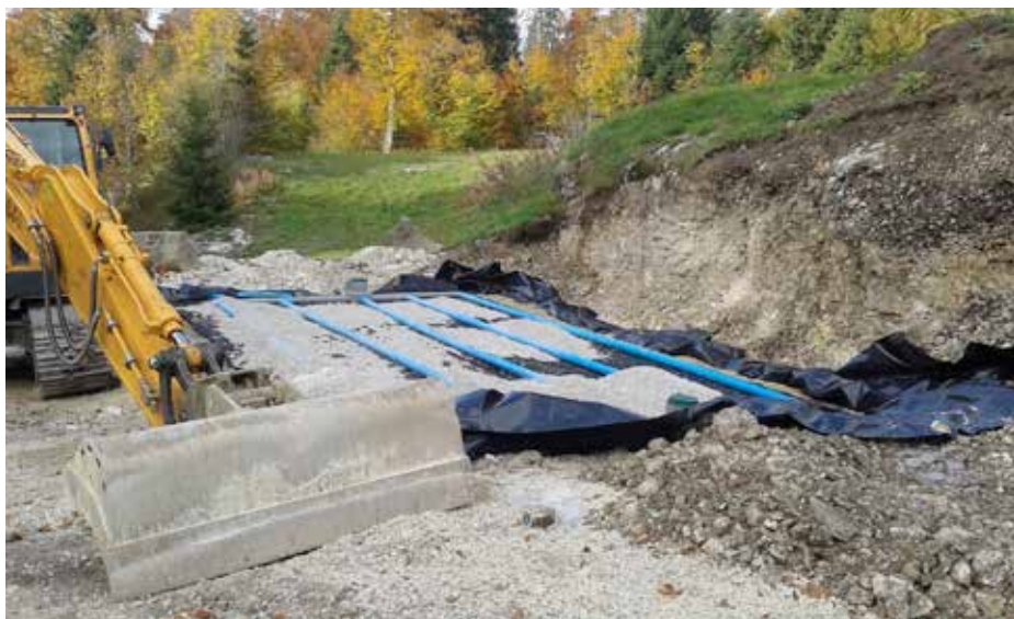
Le Chalet de la Bourre dispose désormais d'un assainissement autonome performant
