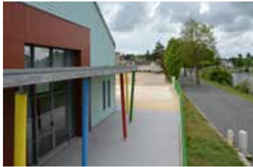
Contrôle accès de la salle des fêtes
