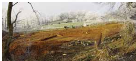
Chiloup, future station d'épuration, deux bassins de filtration plantés de roseaux
